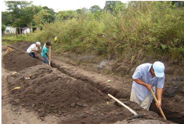
Drenajes y desagües. Foto: José Luis Guarcas.
